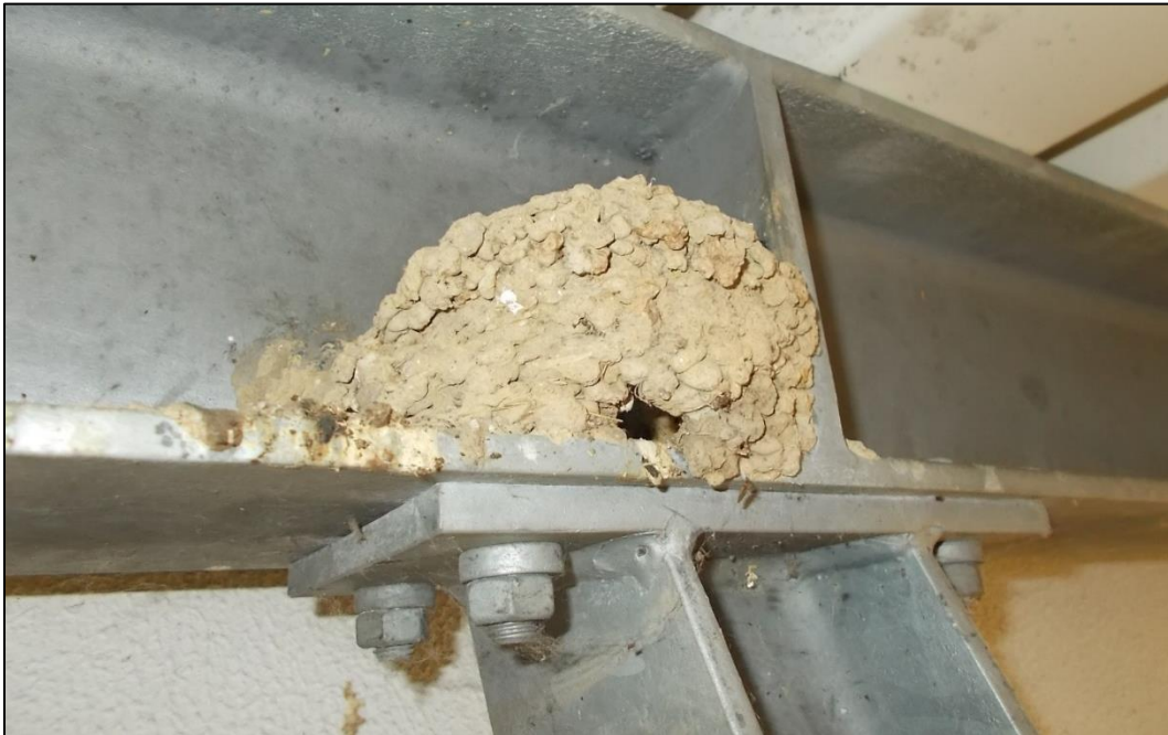
Abbildung 13: Nahansicht des Rauchschalbennests.
