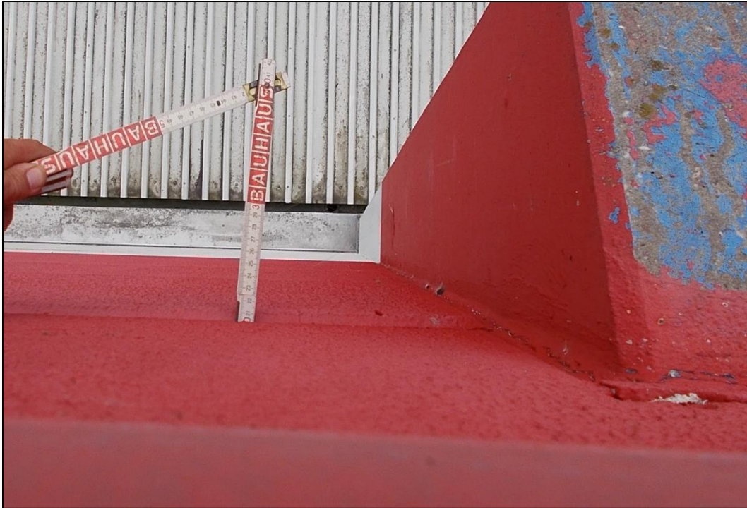
Abbildung 6: Ansicht eines 20 cm tiefen Spalts (ein Zollstockglied) im Bereich der Fassadenpfosten.
