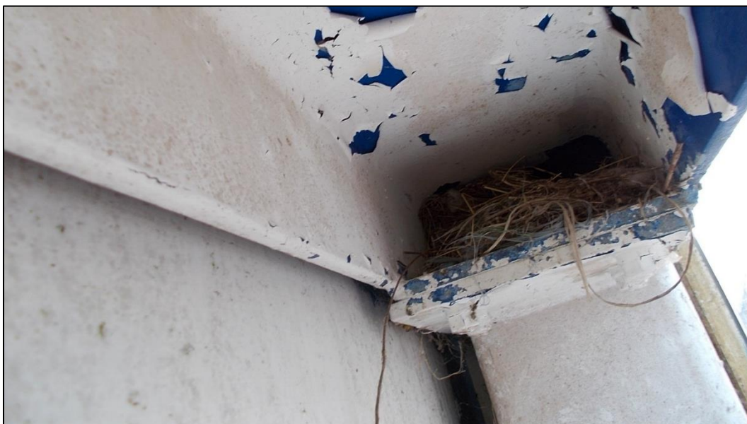
Abbildung 9: Nistplatz des Haussperlings oberhalb eines Stahlpfeilers im überdachten Eingangsbereich.
