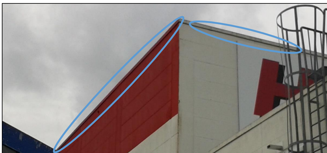
Abbildung 2: Beispielansicht der senkrechten Spalten hinter dem abstehenden Traufblech (blau umrandet).
