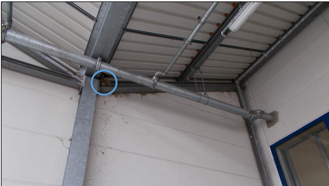
Abbildung 11: Nistplätze des Haussperlings (blau umrandet) an den gebäudenahen Stahlträgern.
