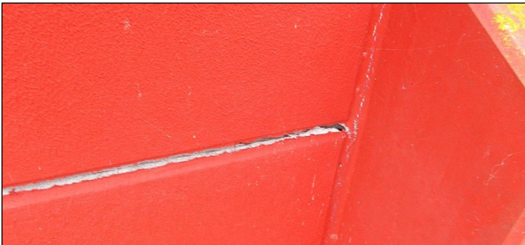
Abbildung 5: Ansicht auf einen der tieferen Spalten nahe dem Fassadenpfosten.
