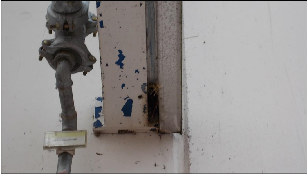
Abbildung 10: Nestmaterial des Haussperlings im Bereich der Stahlbalken der Vordachkonstruktion.
