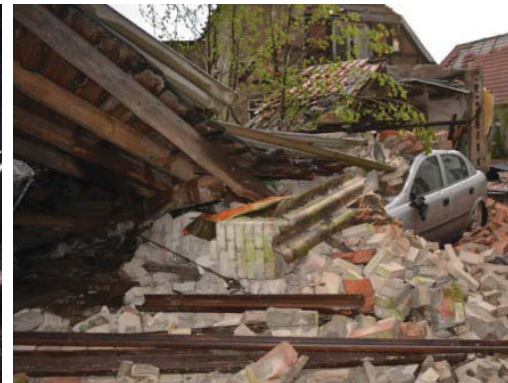
In der 2. Wallstraße in Bützow herrscht nach dem Tornado ein Bild der Verwüstung, Foto: Ralf Badenschier, Quelle: SVZ 05.05.2015
