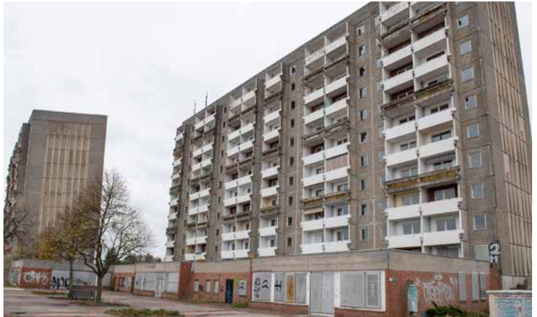
Am 5. November hat die WGS mit dem Rückbau der 35 Jahre alten Hochhäuser in der Rostocker Straße 5 - 7 begonnen.
